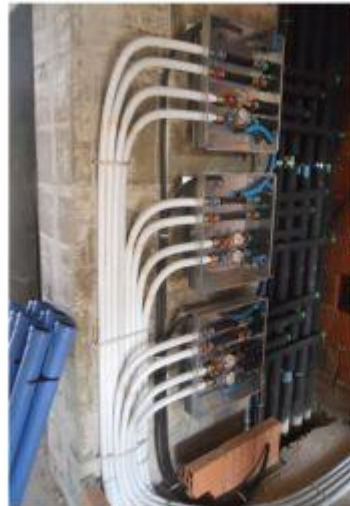
Cassette di contabilizzazione per riscaldamento e acqua calda sanitaria. Water meters for measuring heating and hot water consumption.
